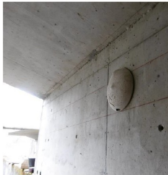
Nichoir de type médaillon G+ installé sur l'OH 260B
