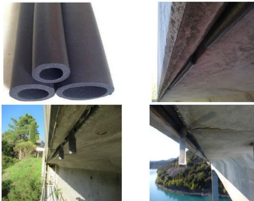
Figure 19. Manchons d'isolation creux et dispositifs anti-retour (tubes PVC + fourreaux) installés au niveau d'une corniche (© NATURALIA Env.)
